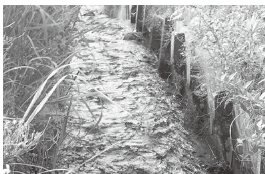
本一の崩れそうな水路壁
