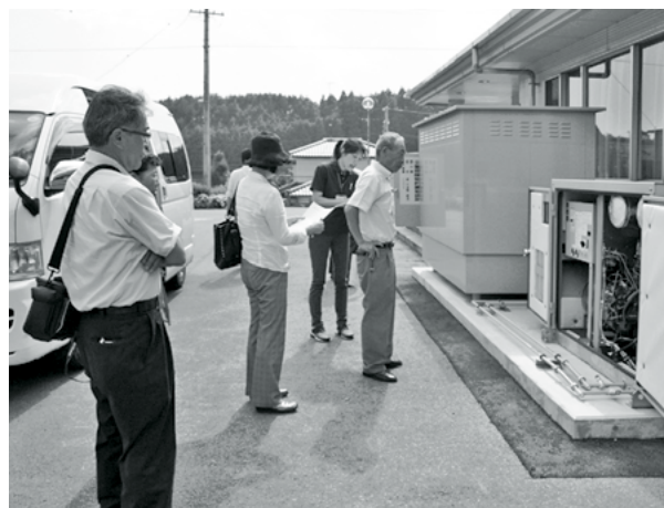
非常用電源(田切体育館)
