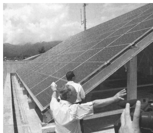
〇〇町役場の太陽光発電 (長野日報 2010.7.31より)
