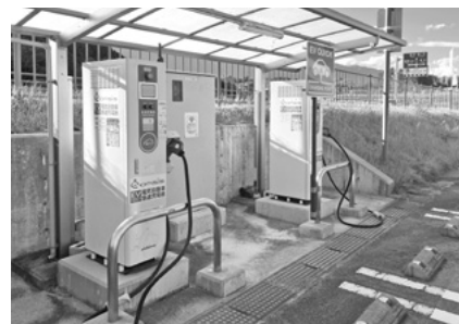
電気自動車充電ステーション「田切の里」
