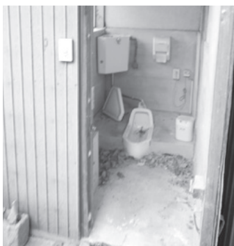
改修が望まれるトイレ
