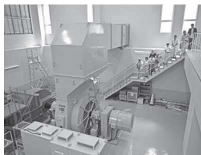
与田切発電所
