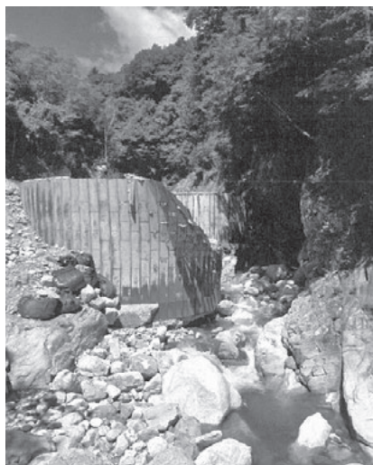
与田切川上流にある第2セルダム。巨大な岩が流されて、破壊されたと思われる
