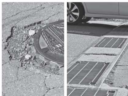
ダンプ通行で壊れた道路
