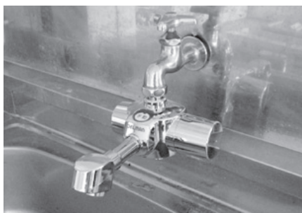
センサ式自動水栓（施工後）
