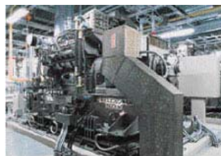
天然ガスコージェネレーション設備
