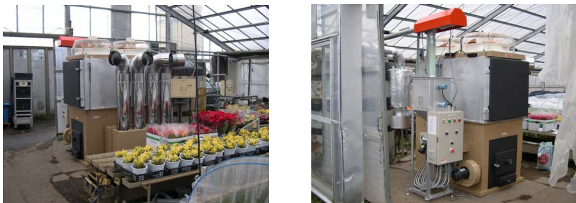
図 7.1.8-3 ペレットボイラ（温風）
