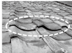
瓦に浮き上がりが生じている
