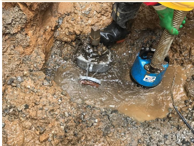
仕切弁フランジ部の漏水
